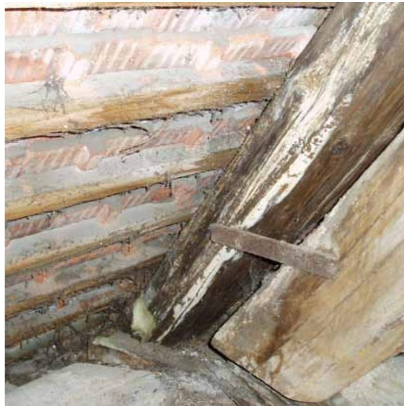
Morsches Dachgebälk der Alten Marienkirche Süßen
